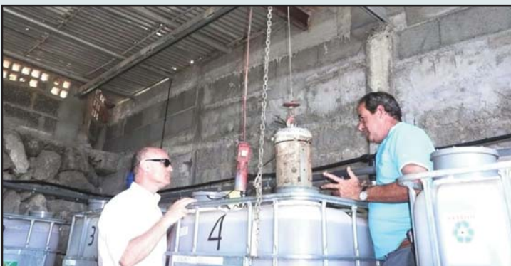
Instalación de depósitos fermentadores de abonos líquidos orgánicos con un polipasto suspendido sobre raíles para el manejo de los recipientes de materia orgánica que se incorporan al caldo.
